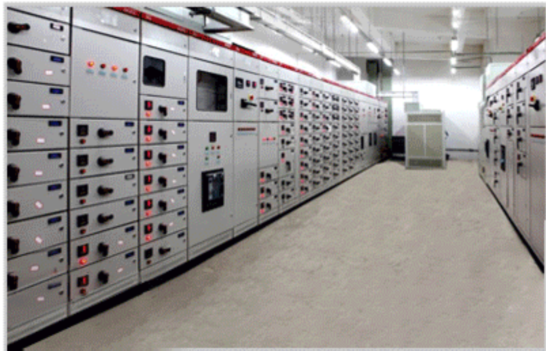
中低压配电柜
